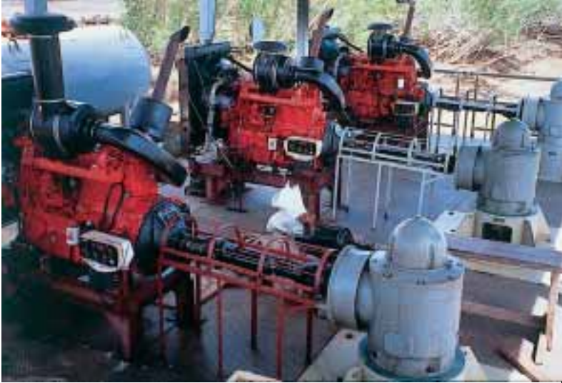
Ensemble moteurs, cardans et renvois d'angle de pompes verticales.
